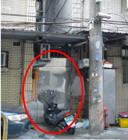
防火巷被搭建圍成私人倉庫
